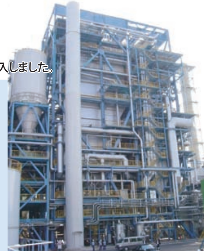
大竹工場の循環流動層ボイラーと関連設備
